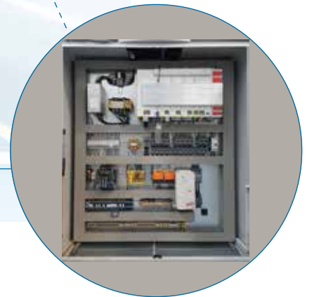
FACILE ACCESSO ALL'ARMADIO ELETTRICO
