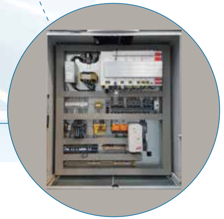
FÁCIL ACCESO A ARMARIO ELÉCTRICO
